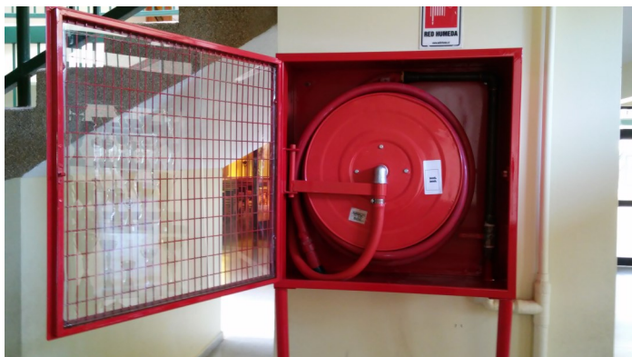
Cajas ubicadas en el interior de las instalaciones sin la protección UV, ya que no es necesario, pero reparadas con su malla y pintura
